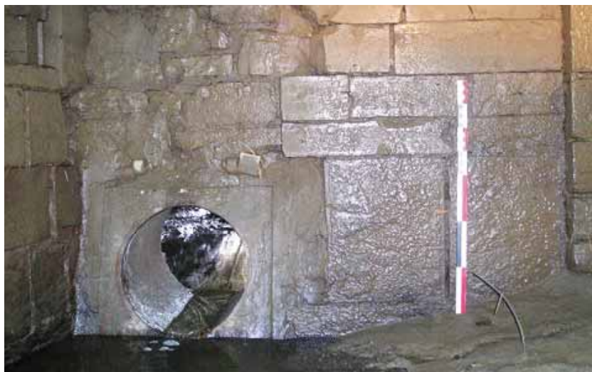
Fig. 8 : Le mur sud-est mesure 2 m de hauteur, sur 2 m 80 de longueur. L'orifice créé a totalement modifié la structure du mur qui devait être en pierre de taille. (Cliché personnel).
