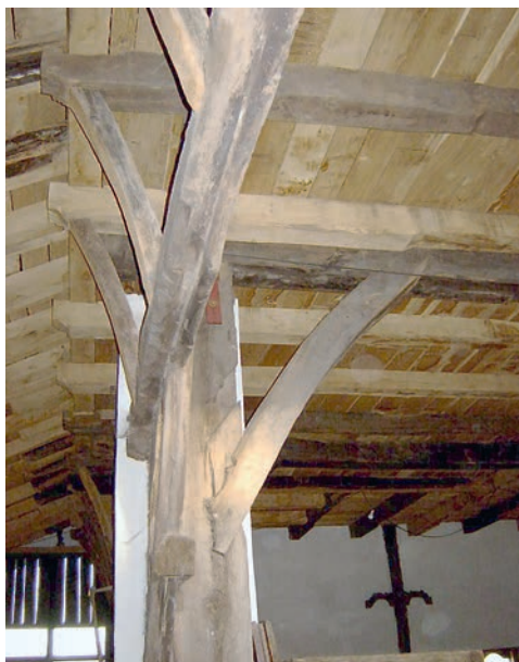
Fig. 4b Une partie du montage de la superstructure du jauregizahar ; les parallèles avec la charpente classique de nombreuses etxe tant nobles que paysannes, comme des reprises de l'église d'Ainhoa, sont flagrants.
